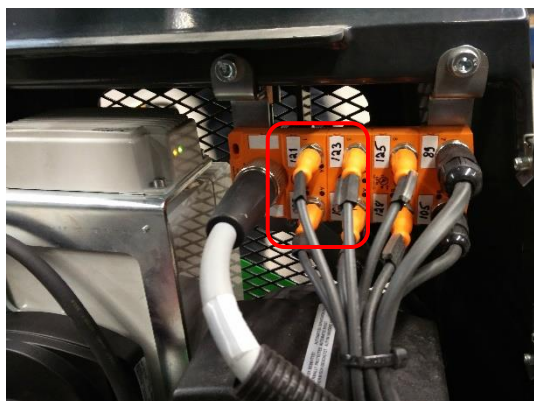
Figura 23: Caja divisora, conectores del estabilizador marcados en el interior del cuadrado rojo
