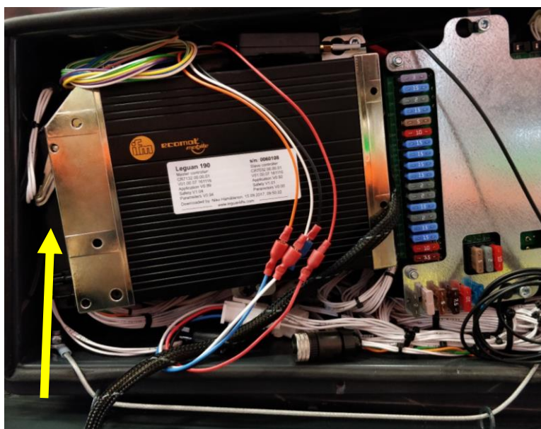
Figura 32. Contactos a los controladores lógicos (2 unidades)
