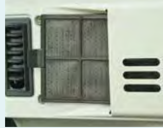
Filtro de aire acondicionado
