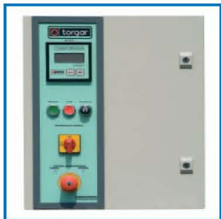
Cuadro de control Control panel
